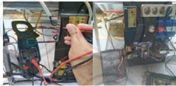
Gambar 4.1.1. Pengujian Tegangan Solar Panel
